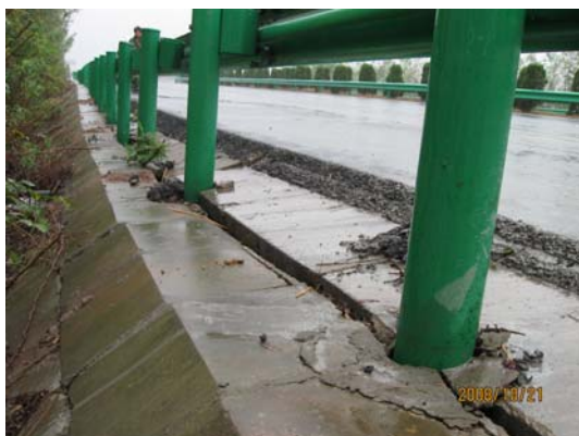
图1 路肩石纵向严重侧移
