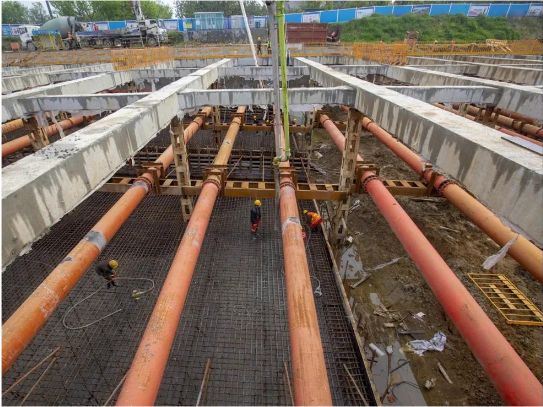
襄阳东西轴线鱼梁洲段项目隧道混凝土浇筑。中交二航局 供图
