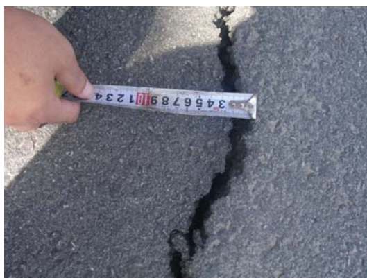
图2 裂缝宽度较宽
